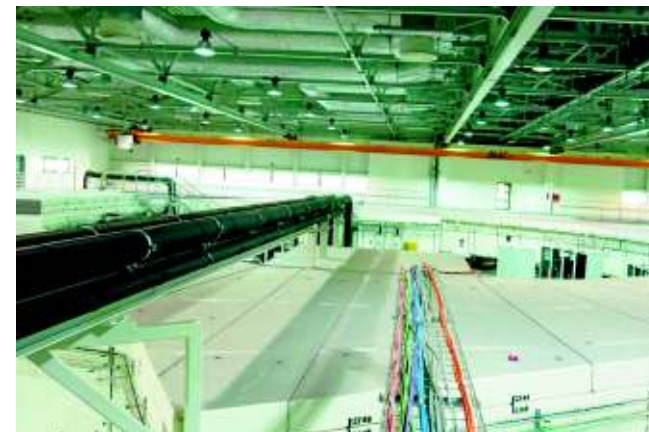
Serce synchrotronu znajduje się za betonowymi osłonami
