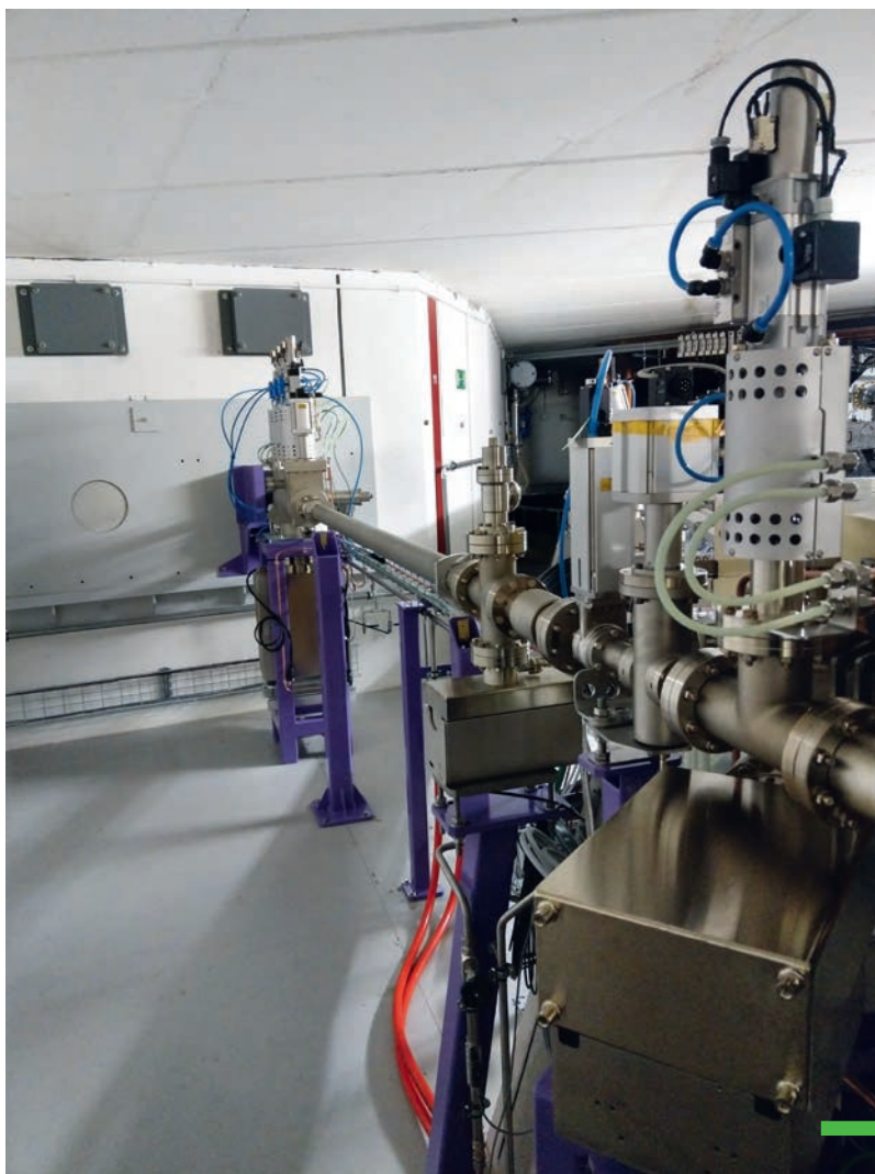
Rysunek 9. Sekcja oddzielająca pierścień akumulacyjny i linię badawczą SOLABS (front end), znajdująca się w tunelu pierścienia akumulacyjnego, zainstalowana w 2020 roku.
